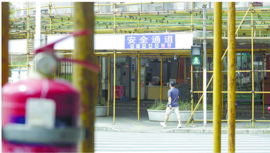
小区的手脚手架越搭越多,仿佛在建工地,居民希望早日解决外墙脱落高空隐患。 /晨报记者 张佳琪
