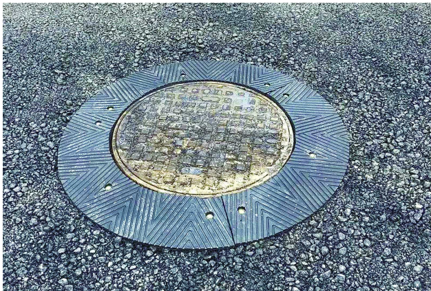
安装了橡胶保护圈的窨井盖
