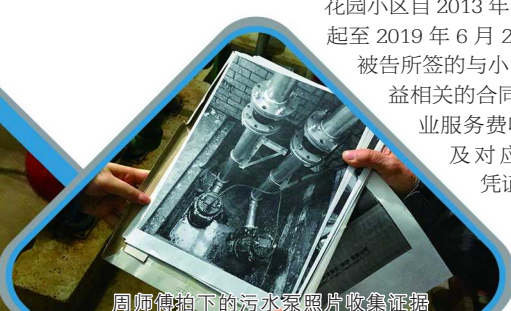
周师傅拍下的污水泵照片收集证据
