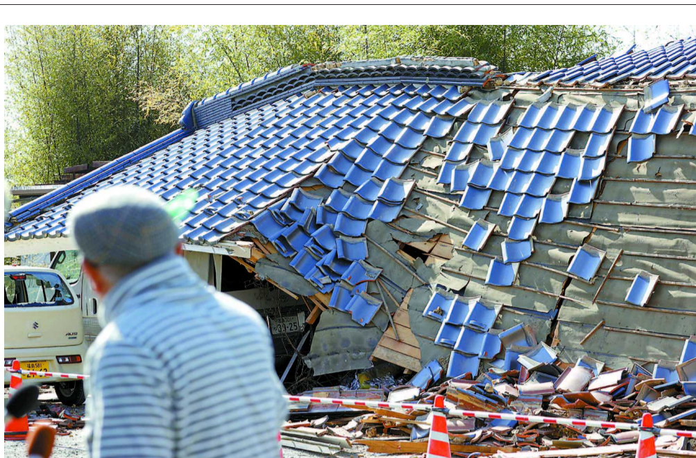
3月17日在日本福岛县国见町拍摄的倒塌的房屋
