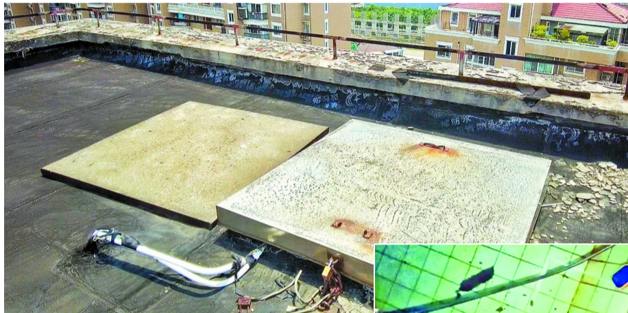
▲紫欣公寓小区2号楼楼顶的水箱
