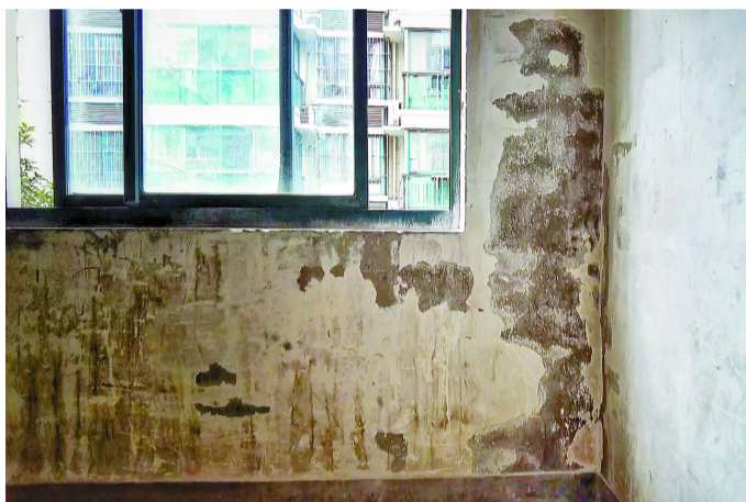
发生渗漏的墙面布满了水渍，白一块，黑一块。 /晨报记者 张佳琪
