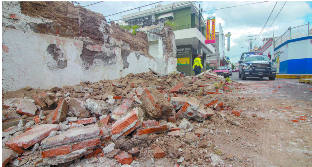
9月19日，墨西哥一处建筑在地震中坍塌。
