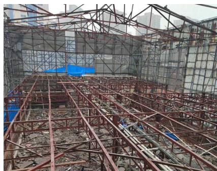
两层违建都用承载力不足的钢结构,安全隐患严重。
