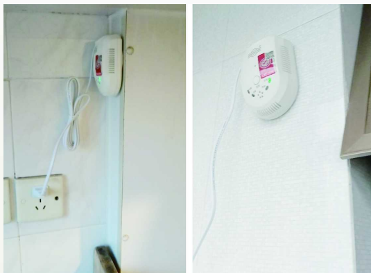
不少沪上居民家在适老化微更新中，装上了燃气报警器
