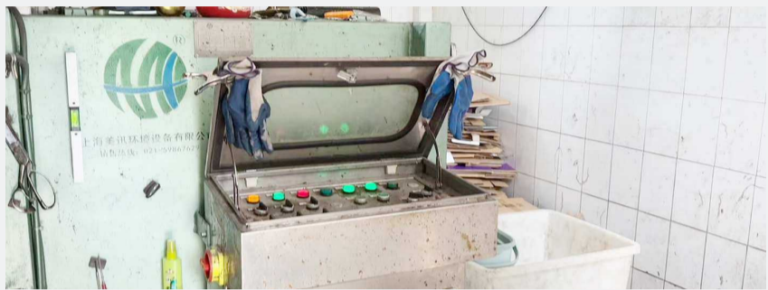
垃圾房里的压缩机
